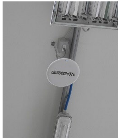
Figura 3 – Antenna per interni a controsoffitto
